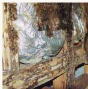
壁内結露による木材の腐食
