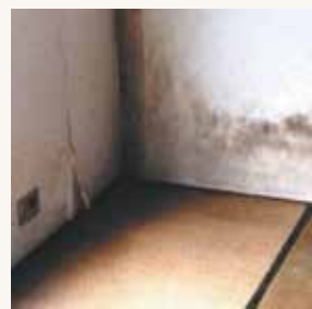
結露が原因で発生したカビ
