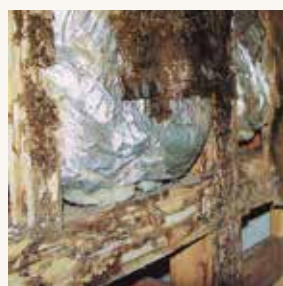
壁内結露による木材の腐食
