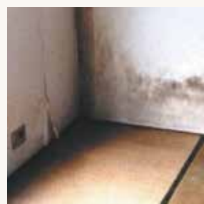
結露が原因で発生したカビ
